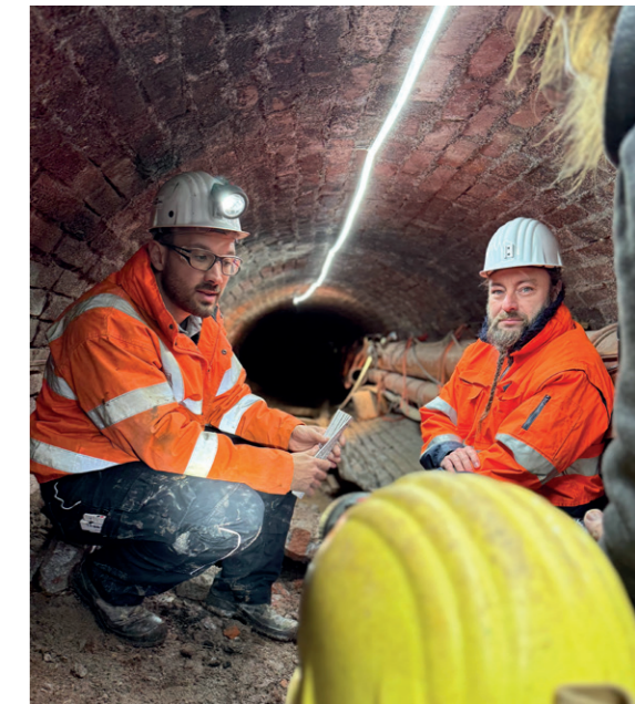
Bauleiter Alfred Geers (links) und Klaus-Peter Michaelis zeigen die zweite Schadstelle.
